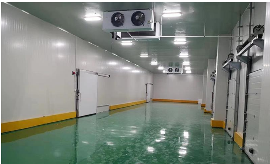
ภาพที่ 6.10 ห้องกักกันความเย็น
